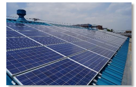
架台 (折板屋根)
